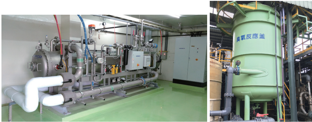
廢水處理之臭氧反應設備
