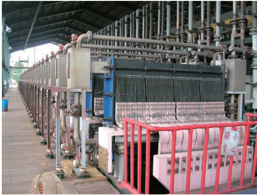
▲ 膜析法電解製程設備
