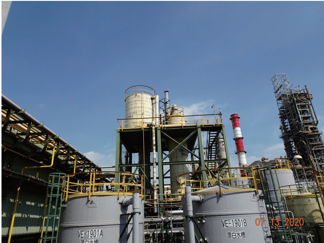
▲ 化學廢氣中和吸收塔設備
