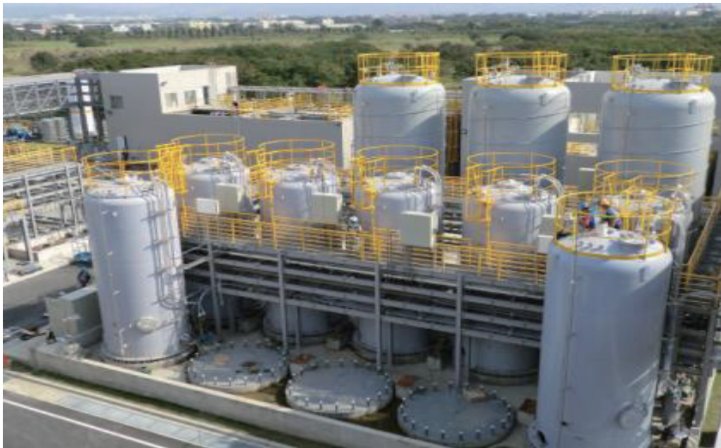
▲ 桶槽清洗之改良方式及設備照片
