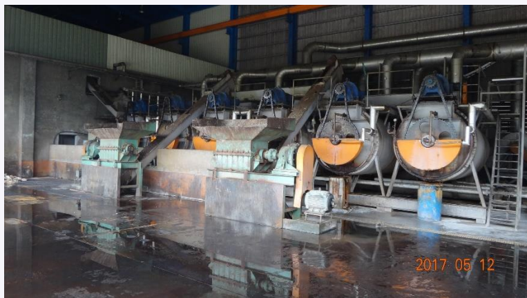
蒸煮化製設備
