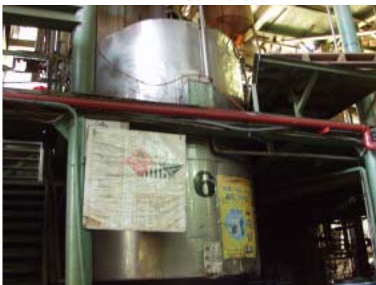
圖6.4.18 毒化物儲存槽
