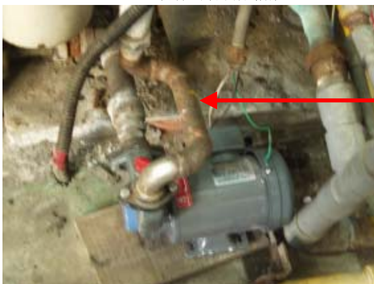
圖8.2.7 管線均有腐蝕情形
