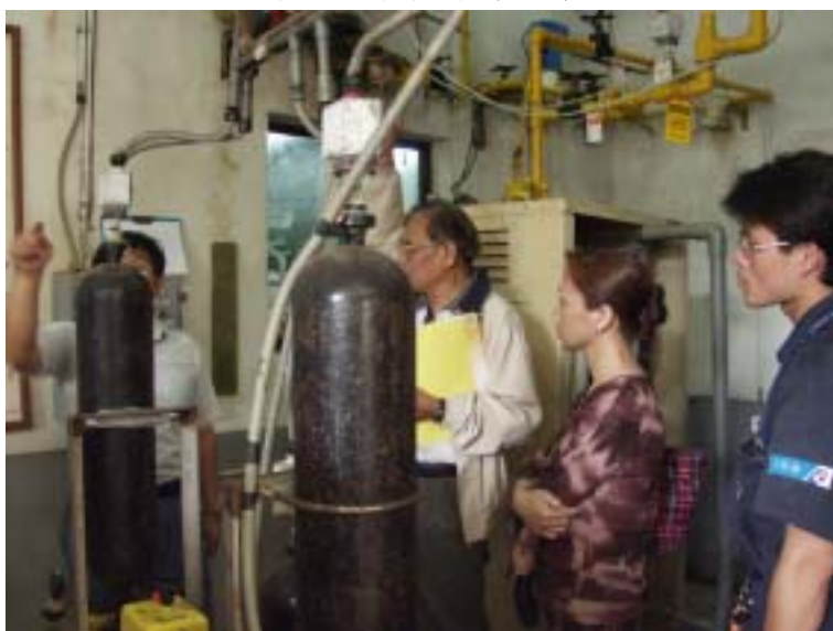
圖8.2.6 廠內氯水管線每五年更新一次
