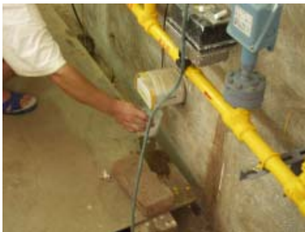
測試狀況下達，偵測設備警報動作
