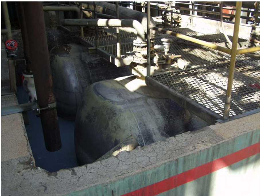
圖六、現場消防廢水侷限於防液堤內收集與回收處理
