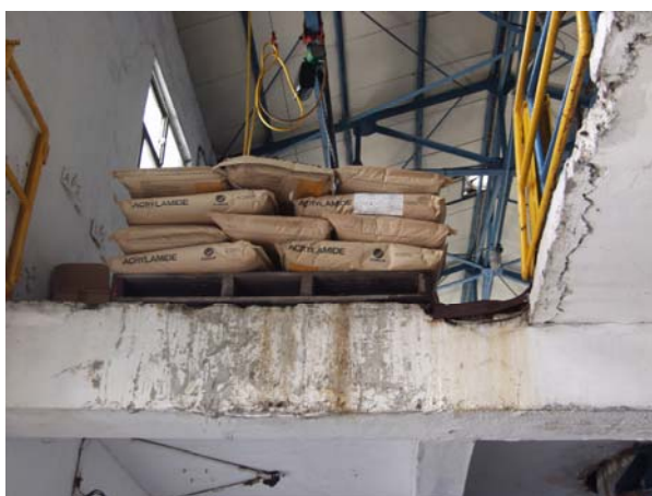
圖二、丙烯醯胺請勿堆置於入料口
