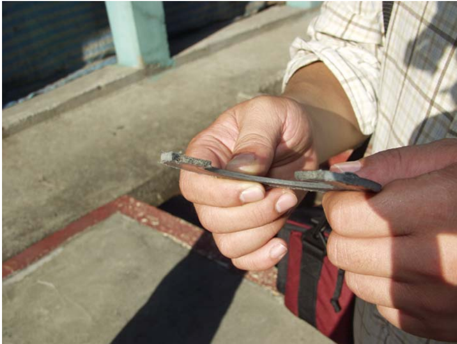
圖五、管線接頭法蘭垫片遭腐蝕斷裂
