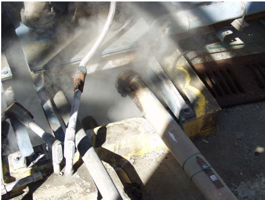
圖四、疑似災害事故潛在引火源(附近高溫蒸氣管線)
