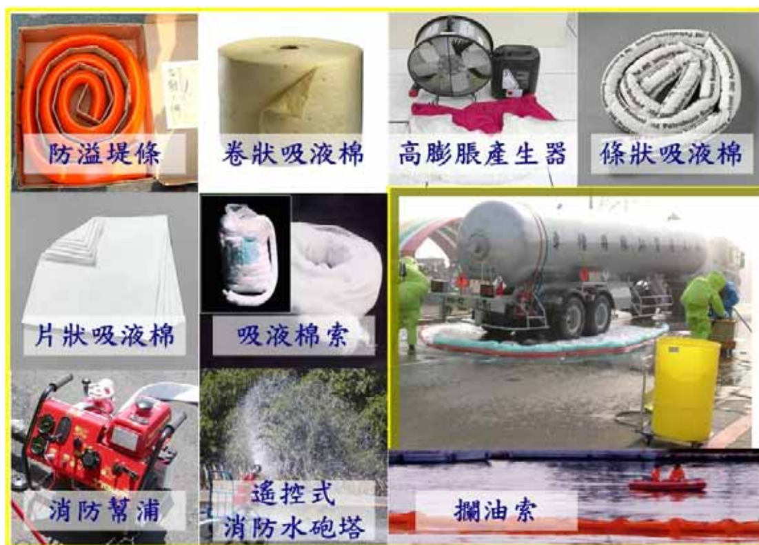
圖 3.1.11、災害現場圍堵外洩毒化物作業情形
