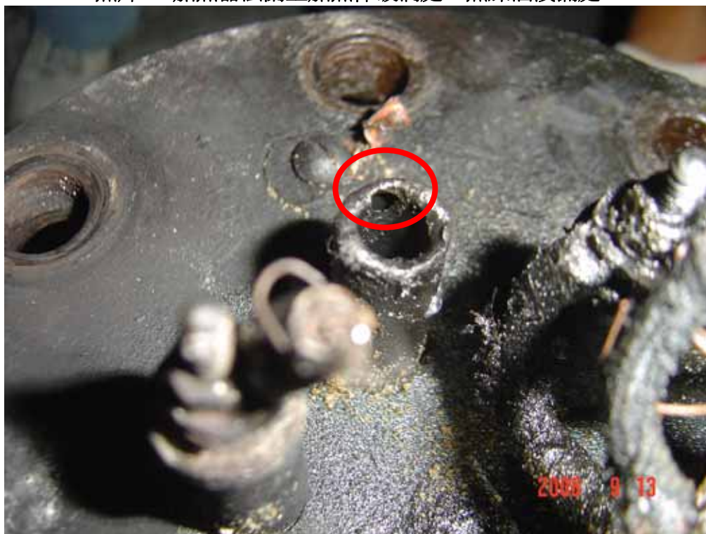
照片7· 加熱器法蘭上加熱棒破洞處，熱媒油洩漏處。
