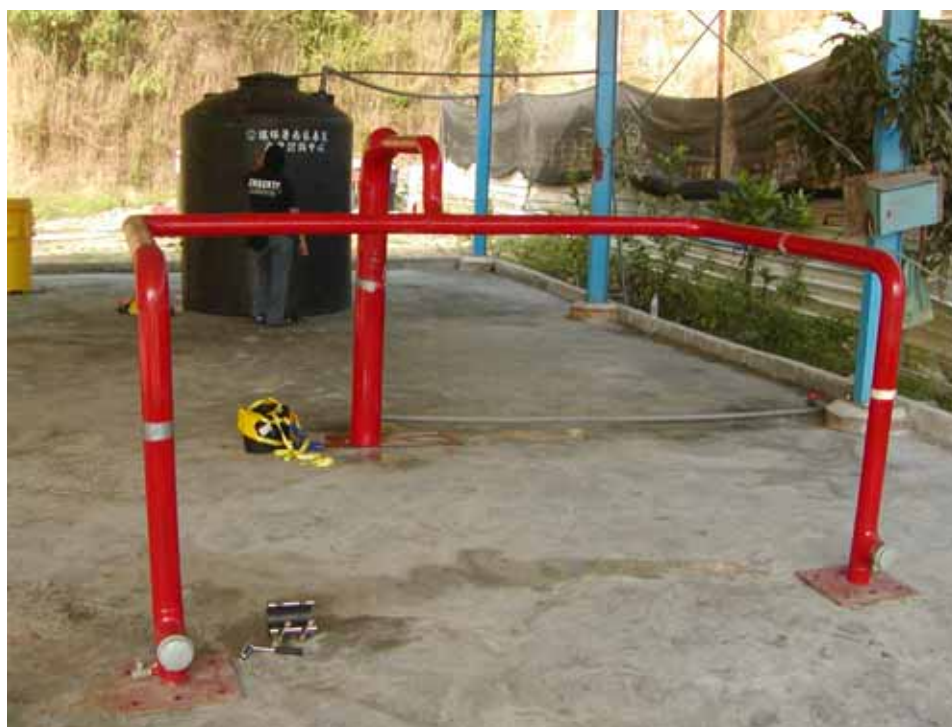
圖 3.1.47、毒災應變實作訓練場_管線洩漏控制
