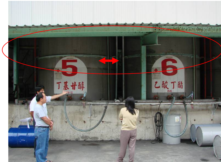
圖六、儲槽間距不足，無消防消滅設備
